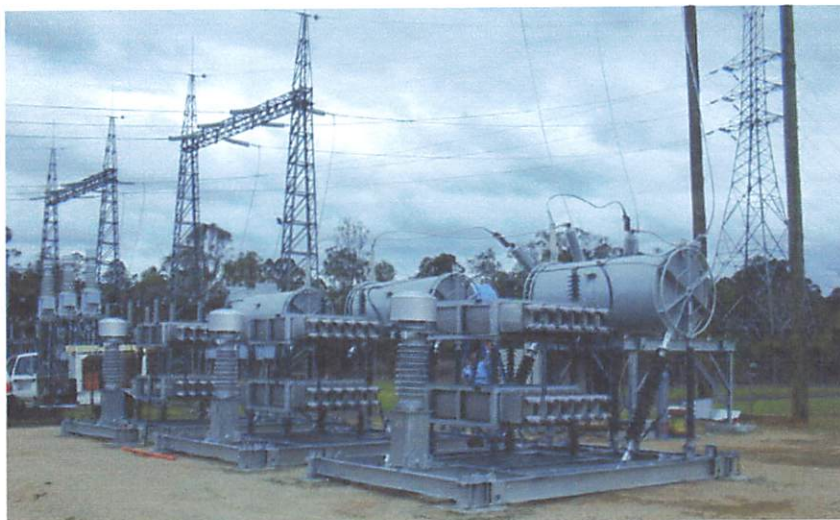
Gambar 2.8 Kapasitor Yang Dipasang Pada Gardu Induk
