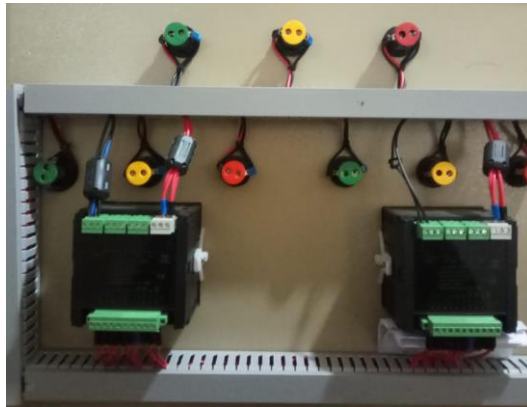
Gambar 4. 3 Realisasi penyambungan port modbus
