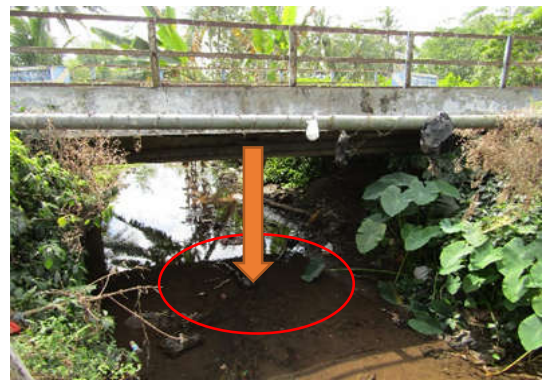
LANTAI SUNGAI BANYAK SEDIMEN
