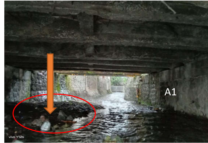
ENDAPAN DI LANTAI JEMBATAN
