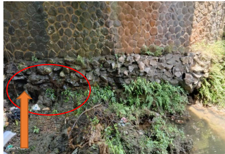
KEPALA JEMBATAN TERKIKIS (A2)
