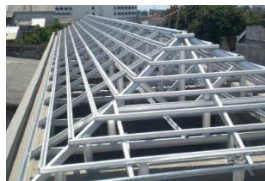
Gambar 9. Kerangka Atap Menggunakan Baja Ringan Sumber: Google, 2023
