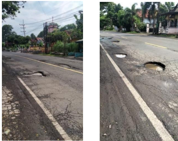
Gambar 1. 2 Kondisi Jalan Bajulmati (Bts.Kab Situbondo) - Ketapang
