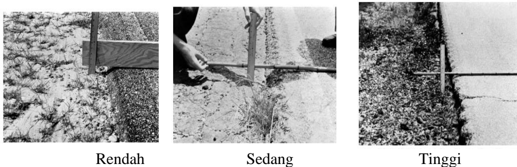
Gambar 2. 9 kerusakan jenis penurunan bahu (Sumber: Indeks Kondisi Perkerasan, 2016)
