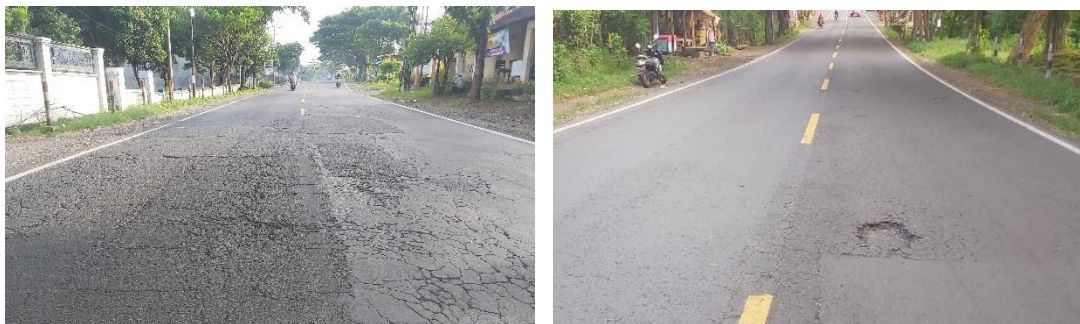
Gambar 4. 4 Kerusakan Lubang dan Retak Buaya
