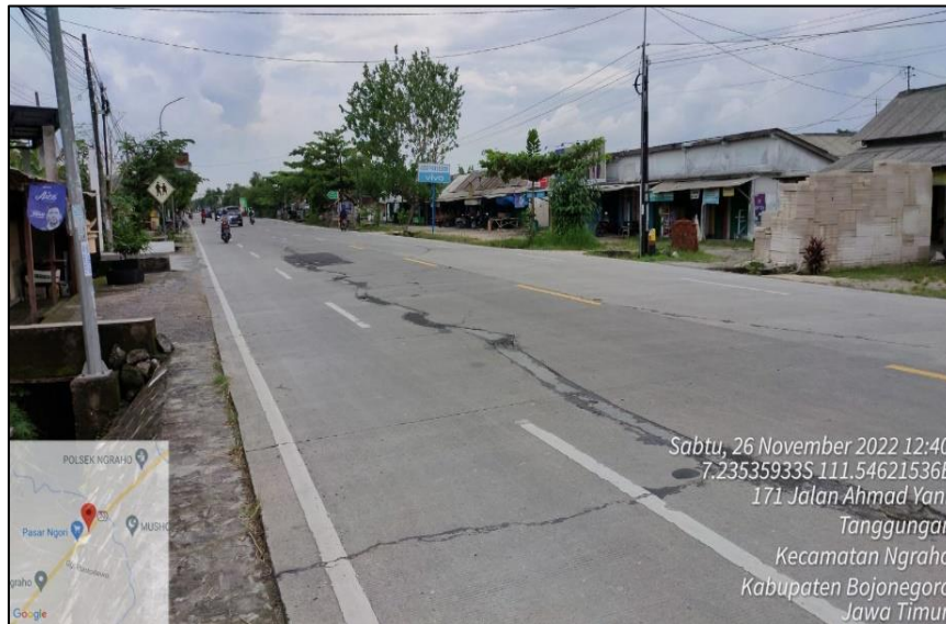
Gambar 1.2. Kondisi Ruas Jalan Padangan
