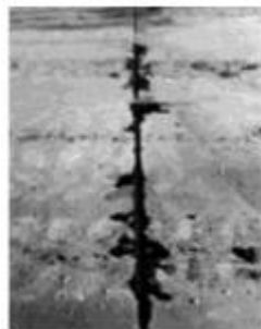
Gambar 2.17. Tingkat kerusakan Pemompaan
