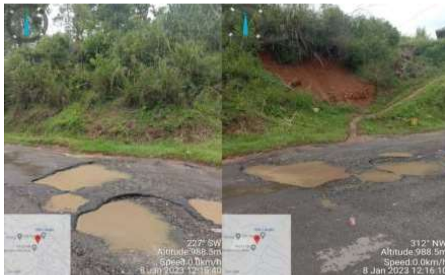
Gambar 1.2 Kondisi Jalan di Ruas Cireng
