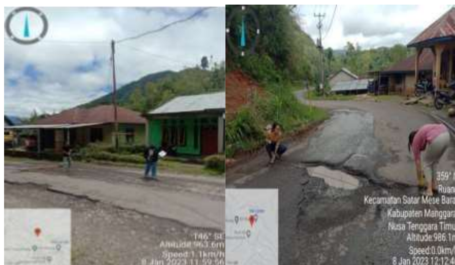
Gambar 1.3 Kondisi Jalan di Ruas Paang Lembor
