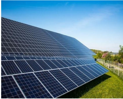
Gambar 1 Pembangkit listrik tenaga Surya
