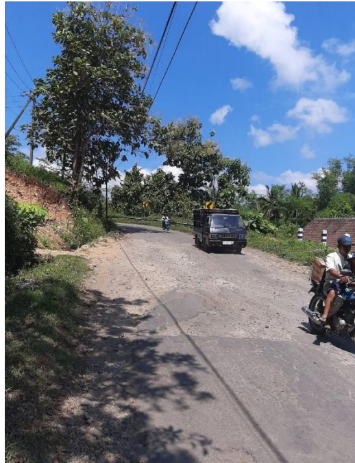
Gambar 1.1 Contoh Kerusakan Jalan pada Ruas Jalan Binangun – Mojorejo
