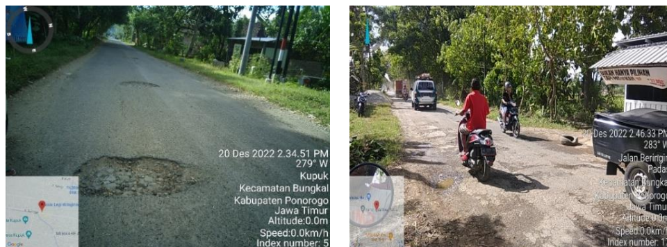
Gambar 1.1 Kerusakan Jalan pada ruas Duwet – Wringinanom
