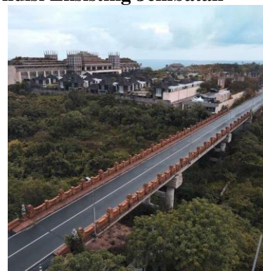
Gambar 5 Kondisi Eksisting Jembatan Sawangan Nikko-Bali
