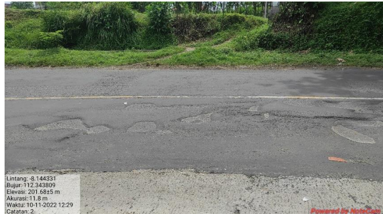
Gambar 1. 1 Kerusakan jalan di lokasi studi
