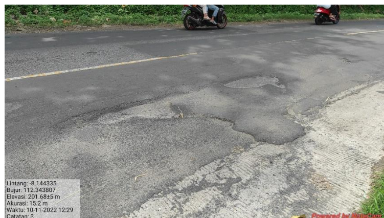
Gambar 1. 2 Kerusakan jalan di lokasi studi
