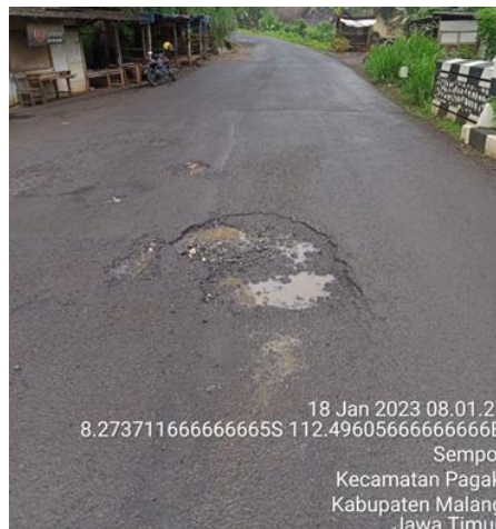
Gambar 1.1 Contoh Kerusakan Lubang Sumber : Dokumentasi Survei 2023
