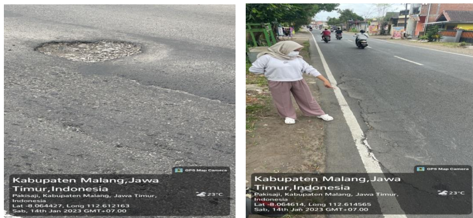
Gambar 1. 1 Kerusakan Jalan pada Ruas Pakisaji – Karangduren di Kabupaten Malang
