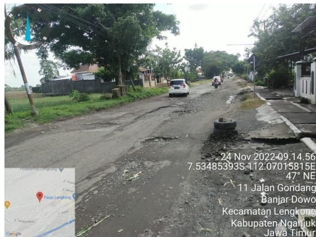
Gambar 1. 1 Kondisi Existing Kerusakan Jalan Sumber: Survey
