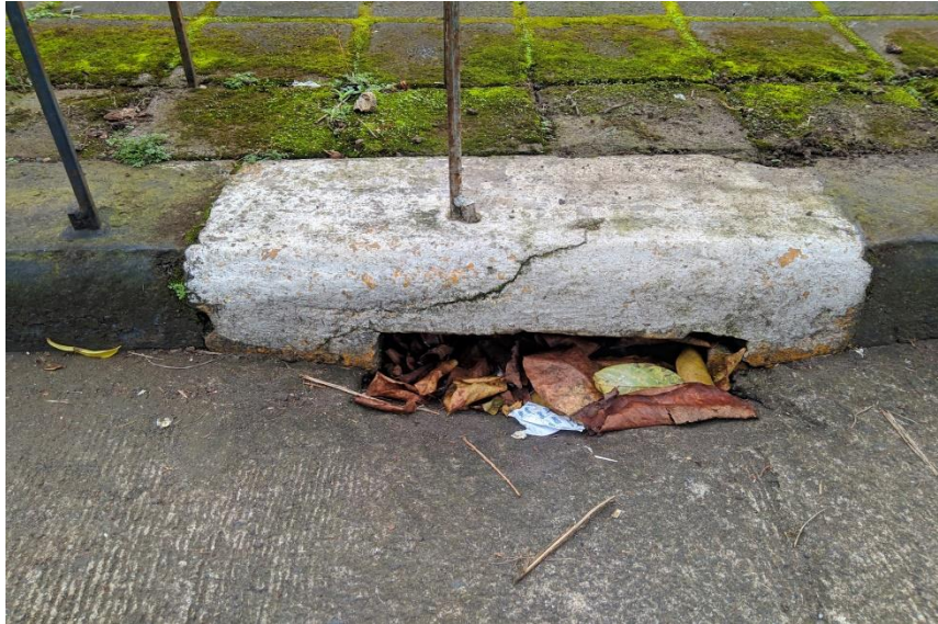
Gambar 1.3 Gambar inlet drainase yang tersumbat pada jl. Ahmad yani, kecamatan kepanjen
