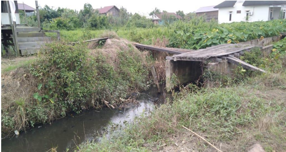
Gambar 1.2 Kondisi Eksisting di Lokasi Studi
