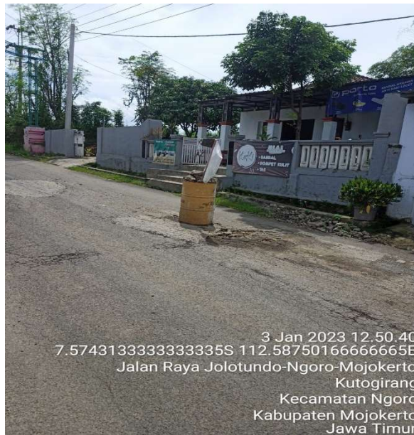
Gambar 1. 2 Beberapa kerusakan jalan lokasi studi penelitian
