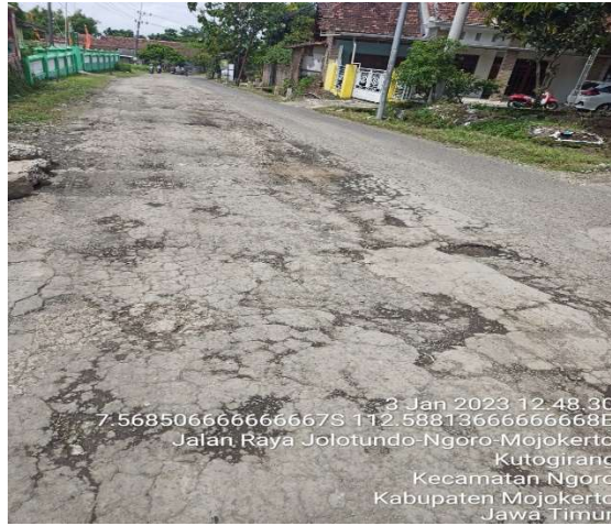
Gambar 1. 1 Beberapa kerusakan jalan lokasi studi penelitian
