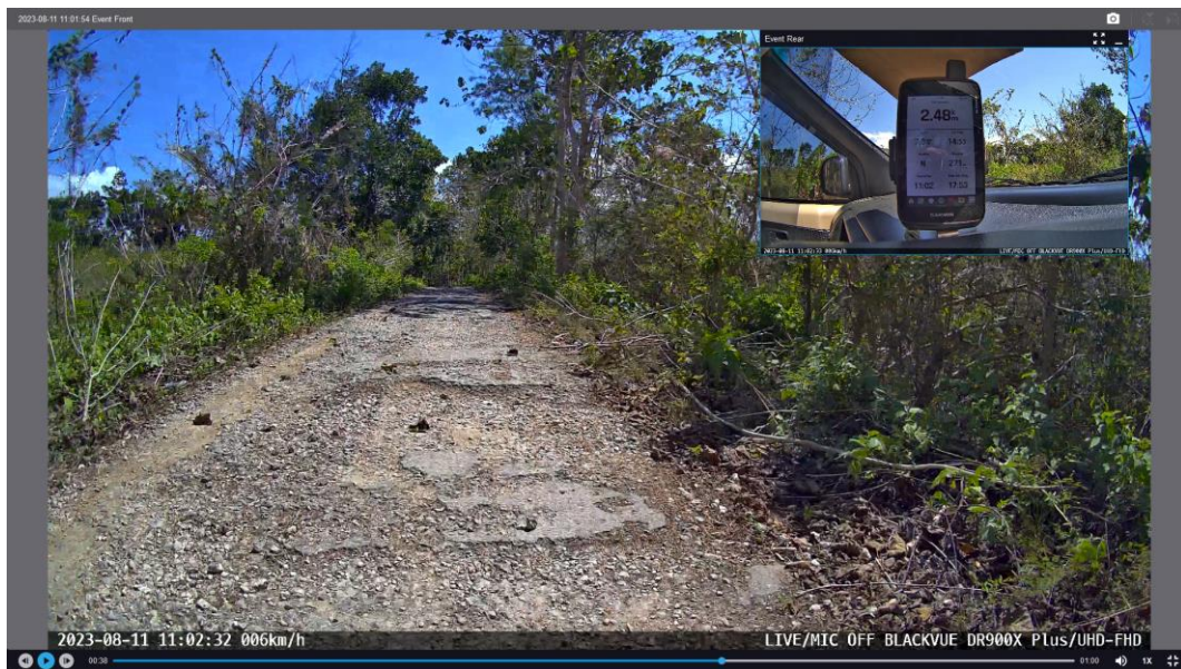
Gambar 1.1a. Kondisi Eksisting Pada Ruas Jalan Kuru Tepe – Mata Kaito Kabupaten Sumba Barat Sumber: Survei Inventaris Sumba Barat dengan Aplikasi Blackvue
