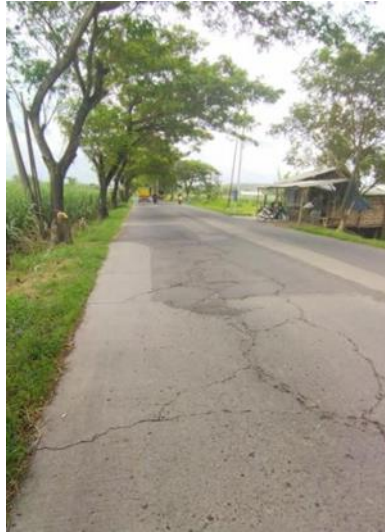
Gambar 1.1 Contoh Kerusakan Jalan Pada Ruas Jalan Provinsi Bts Kab Gresik - Mlirip
