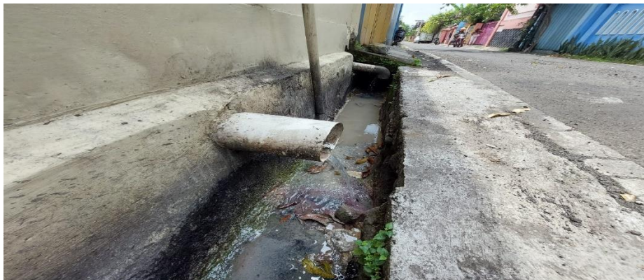
Gambar 3.1 Saluran Buangan Air Limbah Rumah Makan
