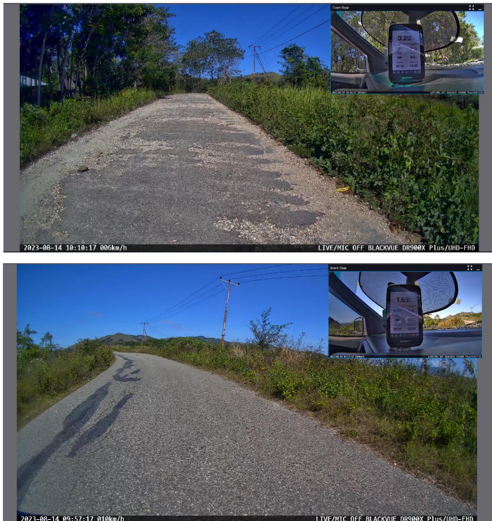
Gambar 1. 4 Kerusakan pada ruas Jalan Weekarou-Sodana Kabupaten Sumba Barat
