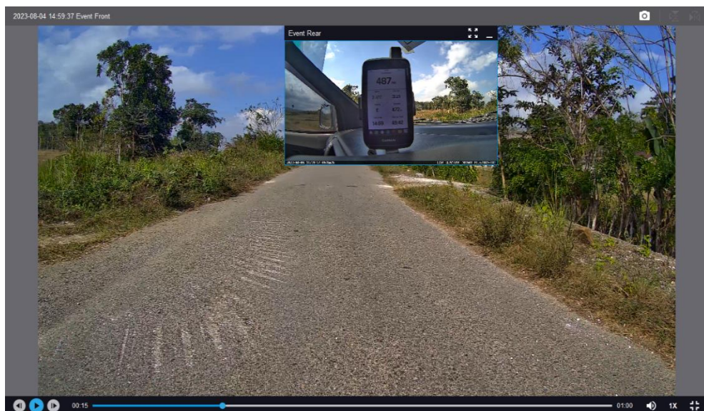
Gambar 1.1 c Kondisi Eksisting Pada Ruas Jalan Gollu Loloka – Sobarade
