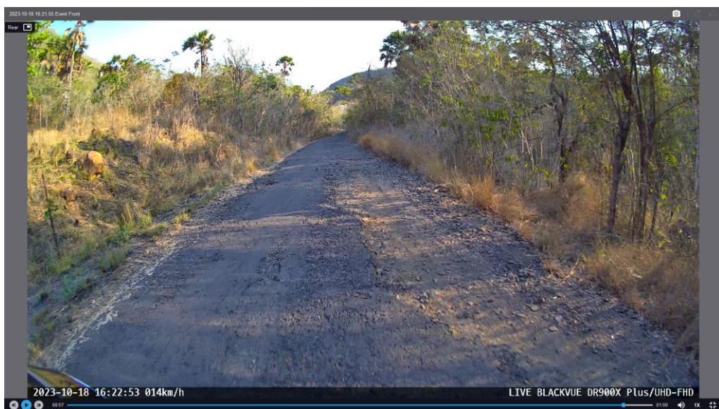
Gambar 1.2. Kondisi Eksisting Pada Ruas Jalan Gorang – Tanawerang Kabupaten Flores Timus
