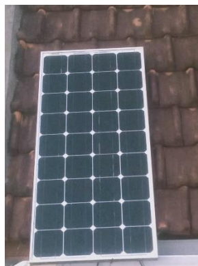
Gambar 4. 14 Panel Surya yang Terpasang
