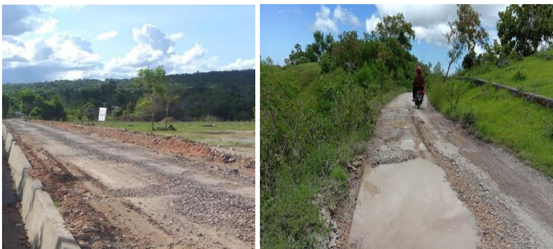
Gambar 1. 1 Contoh kerusakan dan akibat kerusakan ruas jalan Laiwilla – Kabanda Sumber : (PUPR Kabupaten Sumba Timur)
