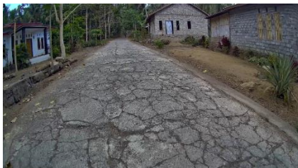
Gambar 3. Kondisi Kerusakan Jalan Tuawolo – Lamalota
