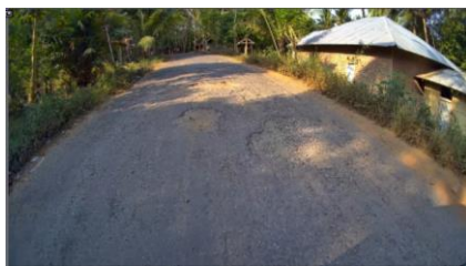
Gambar 2. Kondisi Kerusakan Jalan Lambungan – Watodei
