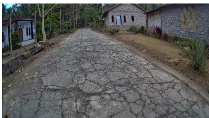
Gambar 3. Kondisi Kerusakan Jalan Tuawolo – Lamalota
