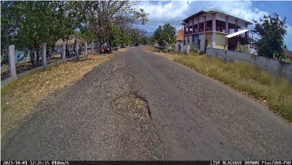
Gambar 5. Lubang pada perkerasan jalan Dalam Kota Larantuka pada STA 0+103
