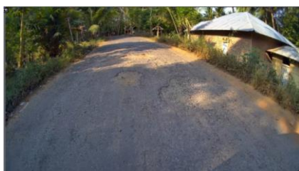
Gambar 2. Kondisi Kerusakan Jalan Lambungan – Watodei
