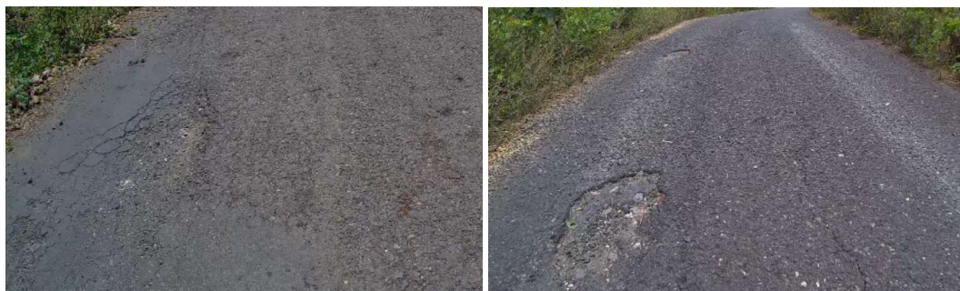
Gambar 1. 1. Beberapa kerusakan perkerasan pada ruas jalan
