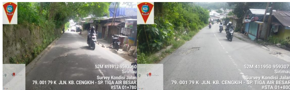
Gambar 1.3 Kondisi Kerusakan Jalan KB Cengkeh – SP 3 Air Besar Kecamatan Sirimau Kota Ambon
