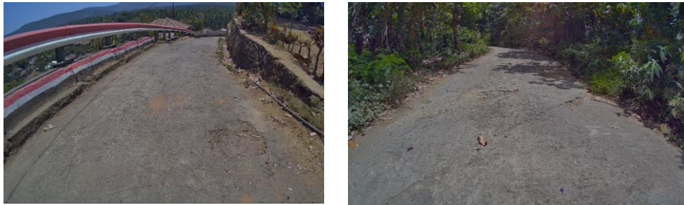
Gambar 1. 1 Kerusakan perkerasan pada 6 ruas di Kabupaten Flores Timur
