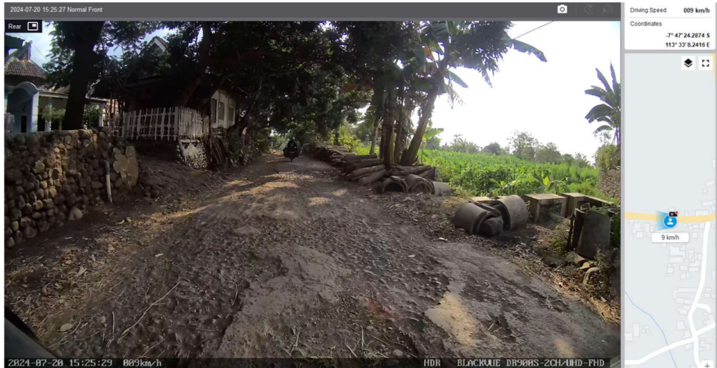
Gambar 1. 5 Kondisi Kerusakan Jalan Pada Ruas Jalan Gondosuli-Pakuniran Sumber : Dokumentasi Hasil Survei,2024
