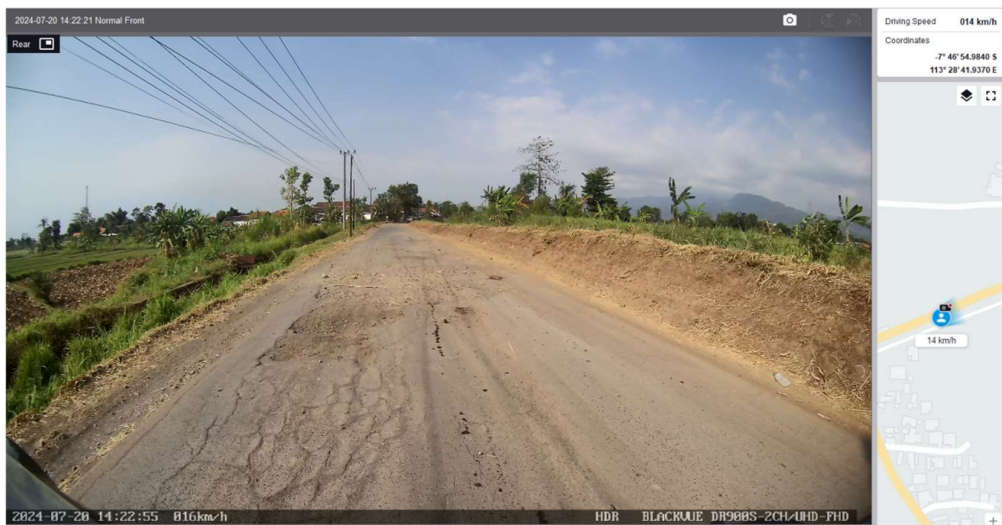
Gambar 1. 2 Kondisi Kerusakan Jalan Pada Ruas Jalan Besuk-Glagah Sumber : Dokumentasi Hasil Survei,2024
