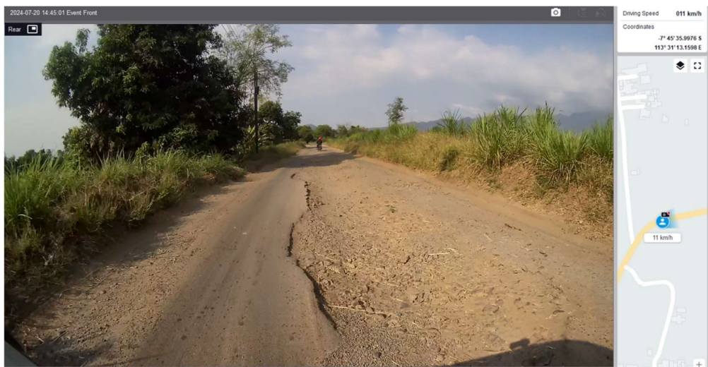
Gambar 1. 3 Kondisi Kerusakan Jalan Pada Ruas Jalan Glagah-Talkandang Sumber : Dokumentasi Hasil Survei,2024
