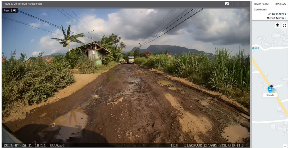
Gambar 1. 4 Kondisi Kerusakan Jalan Pada Ruas Jalan Triwungan-Gondosuli Sumber : Dokumentasi Hasil Survei,2024
