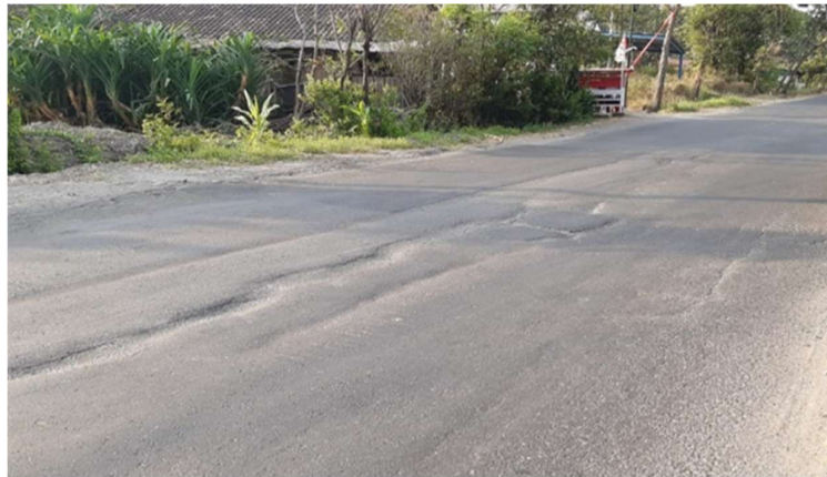
Gambar 2. 9 Retak Blok (Block Cracking)
