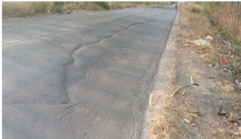
Gambar 2. 7 Retak Refleksi Sambungan ( Joint Reflection Cracking ) Sumber : Dokumentasi Survei, 2024
