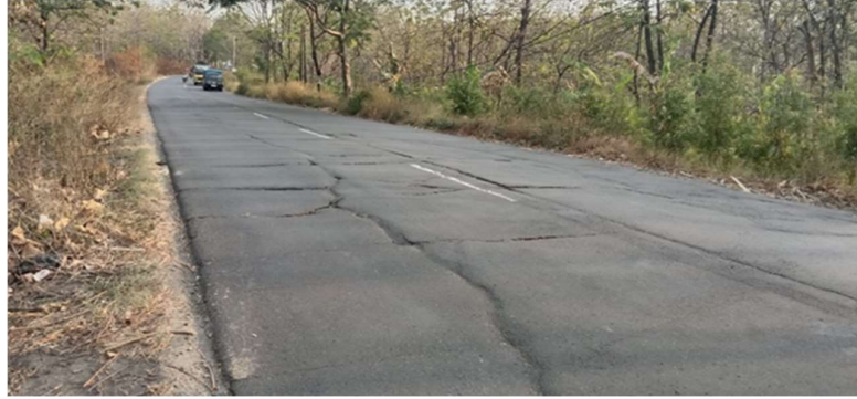
Gambar 2. 8 Retak Memanjang dan Melintang (Longitudinal and Transverse Cracking)
