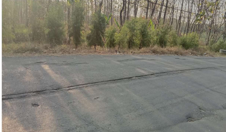
Gambar 2. 10 Retak Sambungan Jalan (Lane Joint Crack)
