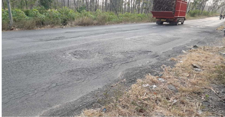
Gambar 2. 5 Retak Pinggir (Edge Crack) Sumber : Dokumentasi Hasil Survei, 2024
