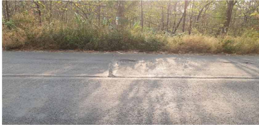
Gambar 2. 6 Retak Sambungan Bahu Perkerasan ( Edge Joint Crack ) Sumber : Dokumentasi Survei, 2024
