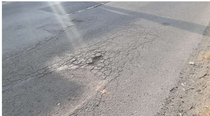
Gambar 2. 4 Retak Kulit Buaya ( Alligator Crack )
