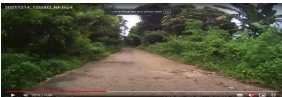
Gambar 2. Lubang pada perkerasan jalan Pero - Rande STA 0+000 hingga STA 0+200
