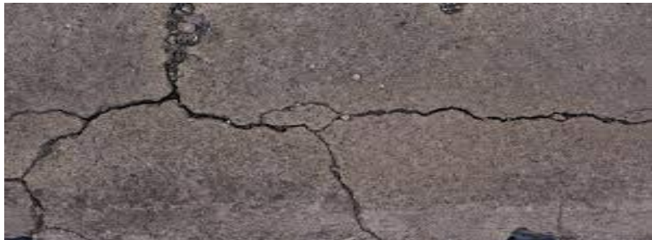
Gambar 2. 12 Kerusakan Retak Bercabang
