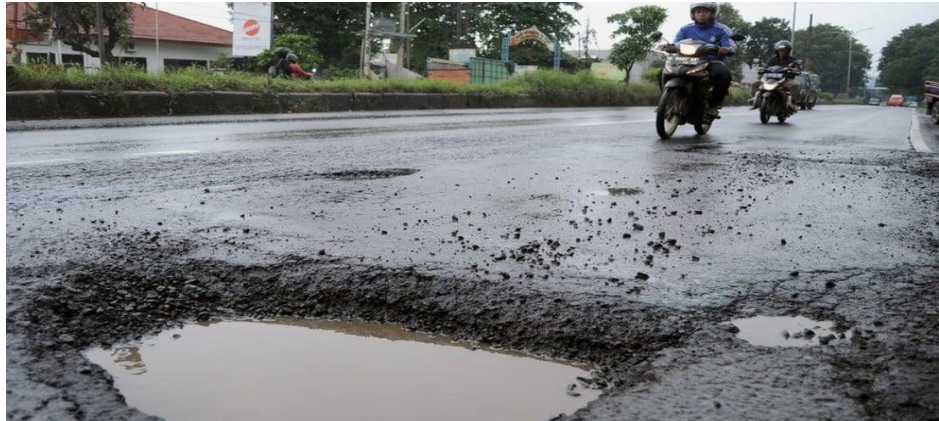
Gambar 2. 7 Kerusakan Lubang ( pot holes )
