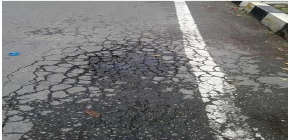
Gambar 2. 5 Retak kulit buaya ( alligator crack )
