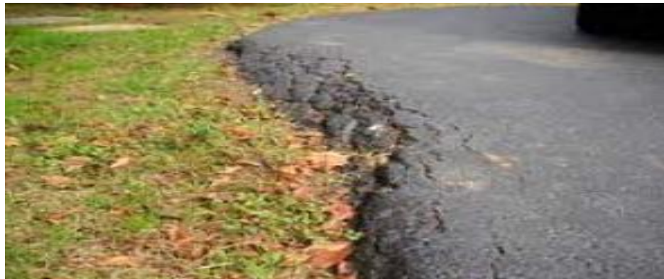
Gambar 2. 8 Kerusakan Retak Pinggir ( Edge Cracking )
