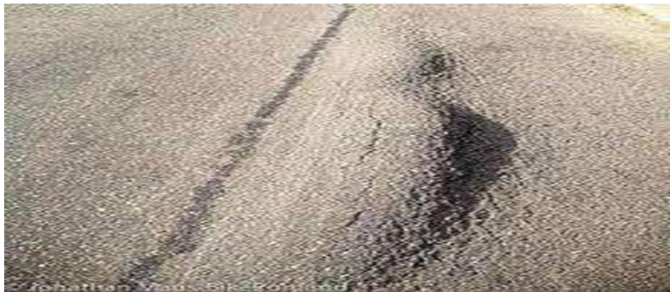
Gambar 2. 10 Kerusakan Kegemukan ( Bleeding )
