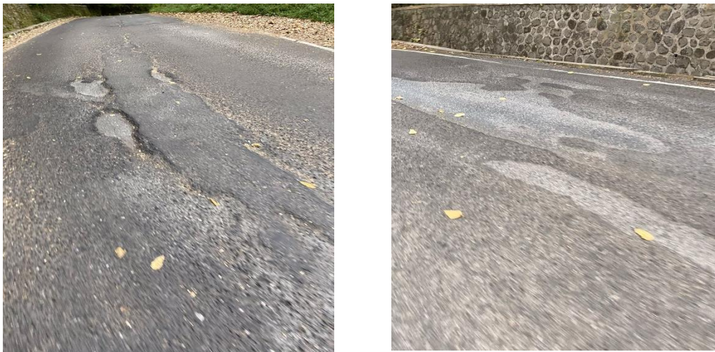
Gambar 1.1 Contoh kerusakan jalan raya ruas Bts. Kota Batu ( Jbt. Cengar II - Pacet ) Kabupaten Mojokerto.
