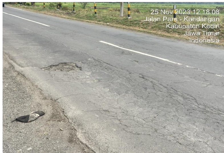
Gambar 1.1 Kondisi Kerusakan Ruas Jalan Kandangan – Bts. Kota. Pare
