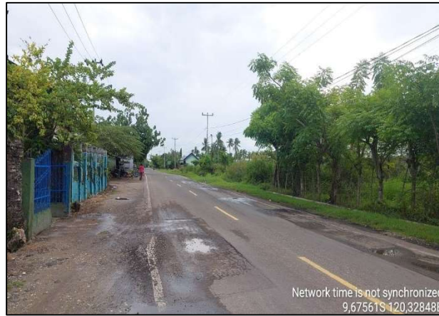
Gambar 1.4 Kerusakan Perkerasan berupa retak dan lubang Sta. 00+950
