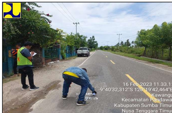
Gambar 1.3 Kerusakan Perkerasan berupa retak dan lubang Sta. 00+950
