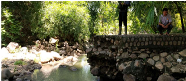
Gambar 1. 1 Dokumentasi Kerusakan Bendung Tambibendo Sumber : Data dari Dinas PUPR Tulungagung.(2025)
