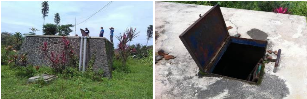
Gambar 3.2 Tandon Air Eksisting Desa Bambang
