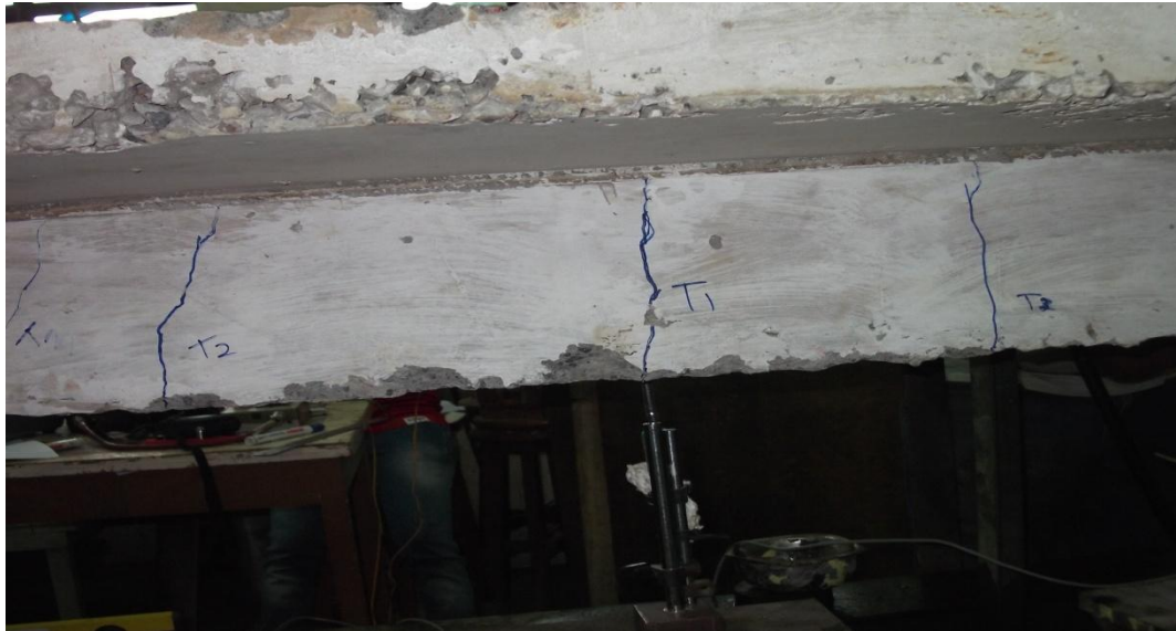
Gambar 4. 27 Pola Retak Balok T Dengan Jarak Sambungan 1/4 ( B )
