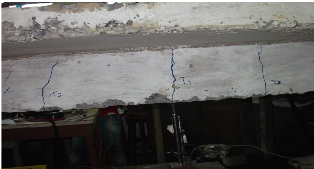
Gambar 4. 17 Pola Retak Balok T Denagan Jarak Sambungan 1/4 ( B )
