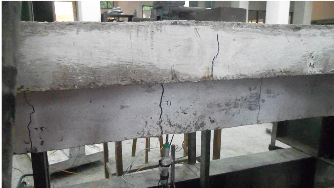
Gambar 4.3 Retak Yang Terjadi Pada Balok T Tanpa Sambungan A ( BTS-A )
