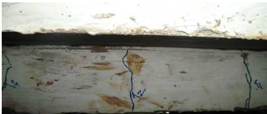
Gambar 4.6 Pola Retak Balok T Tanpa Sambungan Beton dan Tulangan C
