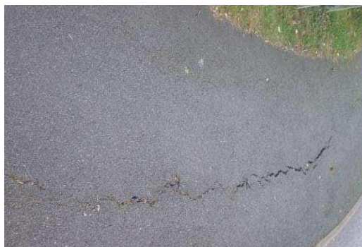
Gambar 2.4 Retak Sambungan Bahu dan Perkerasan
