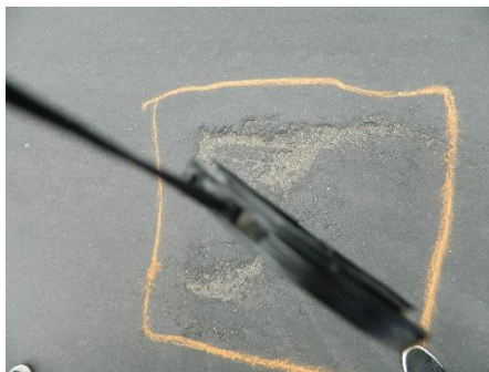
Gambar F28 Area Kerusakan 1
