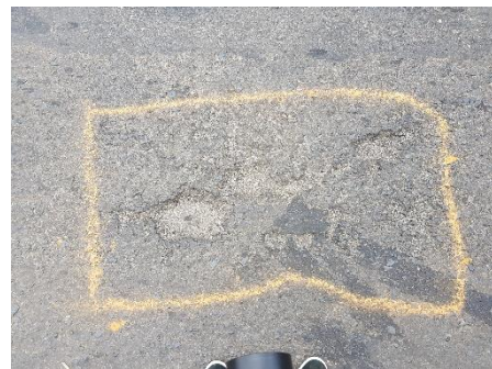
Gambar F29 Area Kerusakan 2
