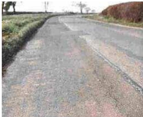
Gambar 2.5 Retak Sambungan Pelebaran Jalan
