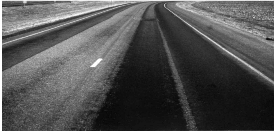
Gambar 2.17 Penurunan pada bekas penanaman utilitas
