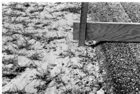
Gambar 2. 14 Penurunan Bahu Jalan
