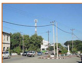
Jaringan Listrik 3 fasa
