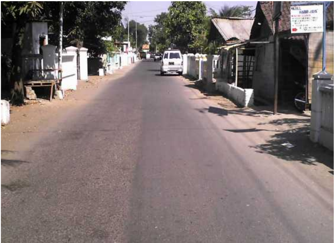
Kondisi Jalan Akses Masuk Jalan Lingkar Timur Kabupaten Sidoarjo
