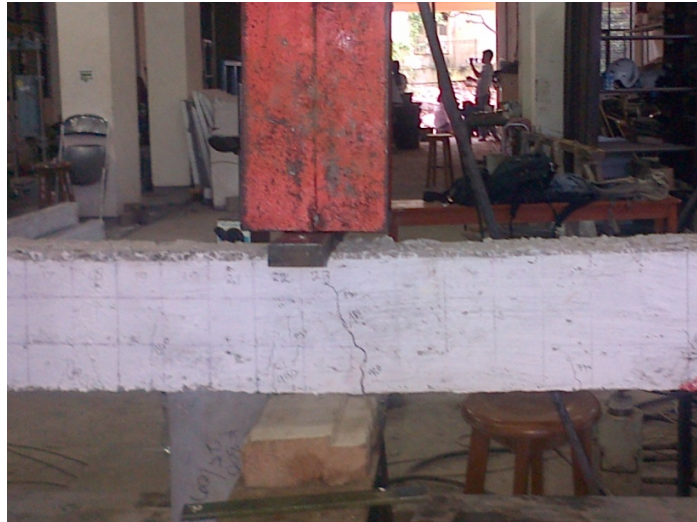
Gambar 4.10 Pola retak balok dengan jarak sambungan beton dan tulangan sepertiga bentang B ( 1/3 )
